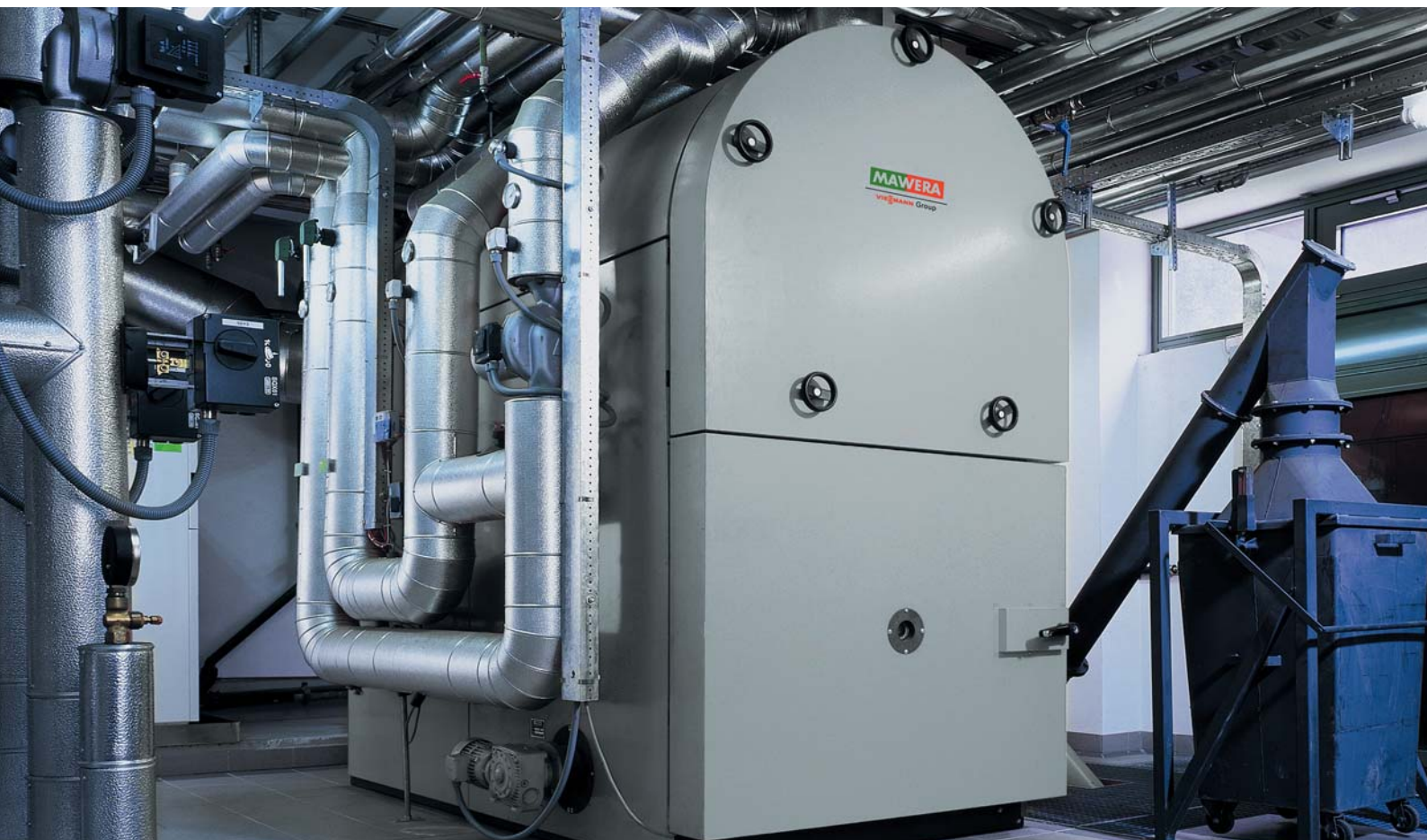
Technologie FU 2500 RA s 2x podsuvným spalováním, Mosser Leimholzbau (výroba lepeného dřeva), Randegg, Rakousko.
